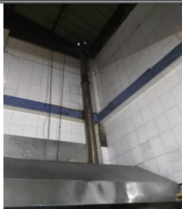
FOTO 4. DUCTO DEL QUEMADOR DEL FREIDOR 1
