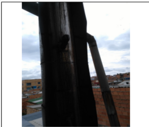
FOTO 5. DUCTO DE EXTRACCIÓN DE LOS FREIDORES
